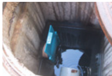
油水分離槽に設置した遮断弁：社員のアイディアがいかされています
