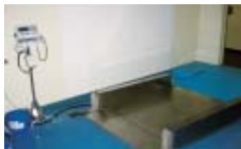
廃棄物の計量システム（新宿本社）計量結果を自動で集計します
