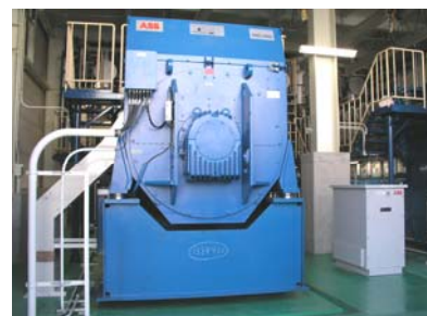
大泉工場に導入した天然ガスコージェネレーションシステム
