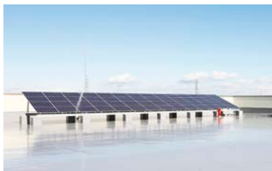
新事務本館の屋上に設置している太陽光発電
