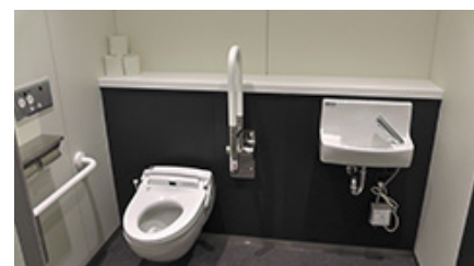
車椅子の方も使用しやすいトイレ（群馬製作所・新西本館）
