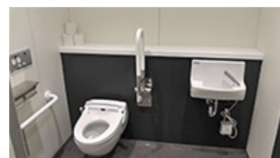
車いすの方も使用しやすいトイレ（群馬製作所・新西本館）
