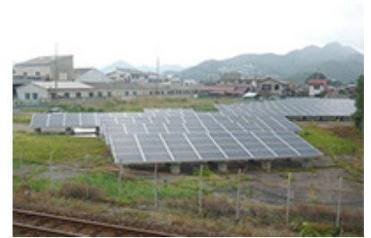
戸建住宅100軒相当の太陽光発電設備
