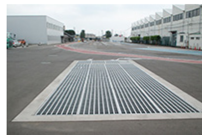
浸水対策（排水口） (宇都宮製作所)
