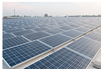
1MWの太陽光発電設備
