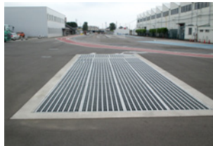
浸水対策（排水口）（宇都宮製作所）
